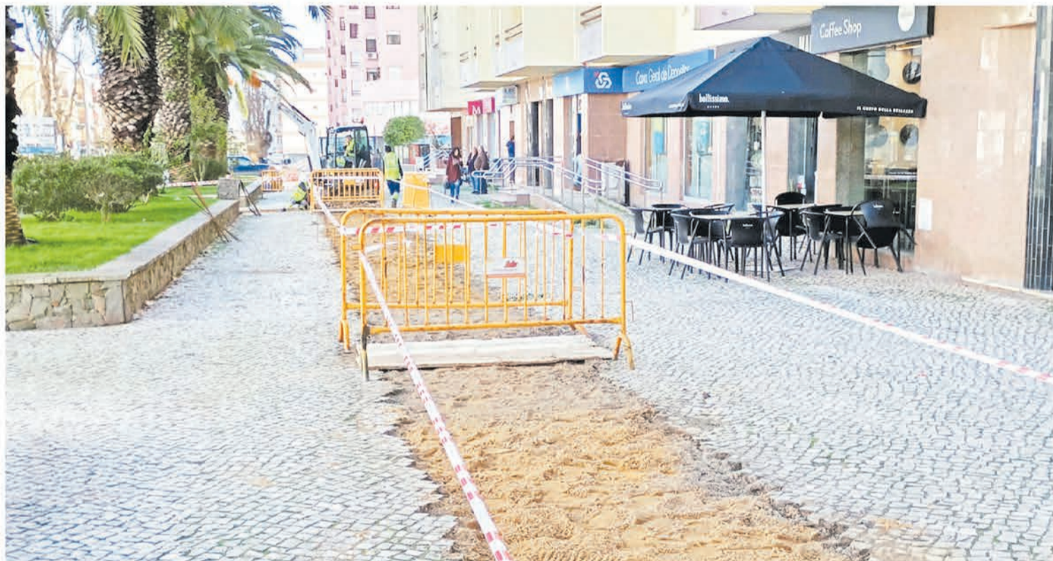
As obras já começaram na Avenida António Rodrigues Manito, nas imediações das instalações do IMT
